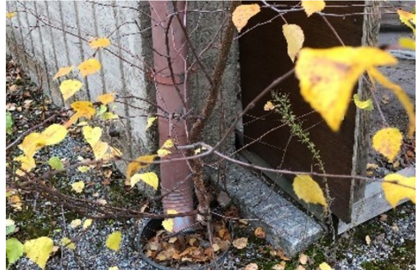
Vanhat sadevesijärjestelmät kaipaavat huoltoa. Kuva Tampereen kaupunki 2021.
