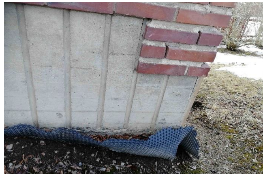
Patolevy liian pitkänä ohjaa vettä perusmuuria vasten ja kastelee rakenteita. Kuva Kuntoselvitys RKM Group Oy 2019.
